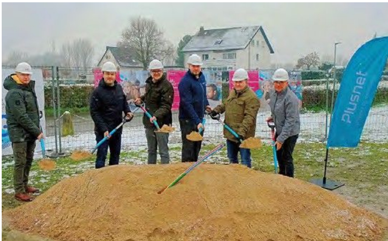
Spatenstich zum Glasfaserausbau durch Plusnet mit Bürgermeister Markus Baier (3.v.l.) am 6. Dezember 2023 in der Alten Hansestadt Lemgo., Bild: Andreas Leber
