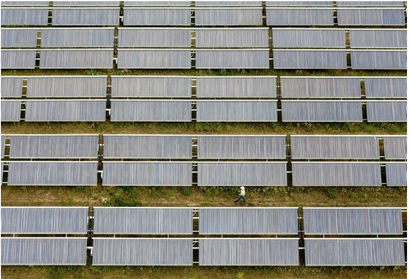
Solarthermie-Kraftwerk in Potsdam: Die Anlage speist jährlich 2,3 Gigawattstunden klimafreundliche Energie in das Fernwärmenetz. Jochen Tack/IMAGO
